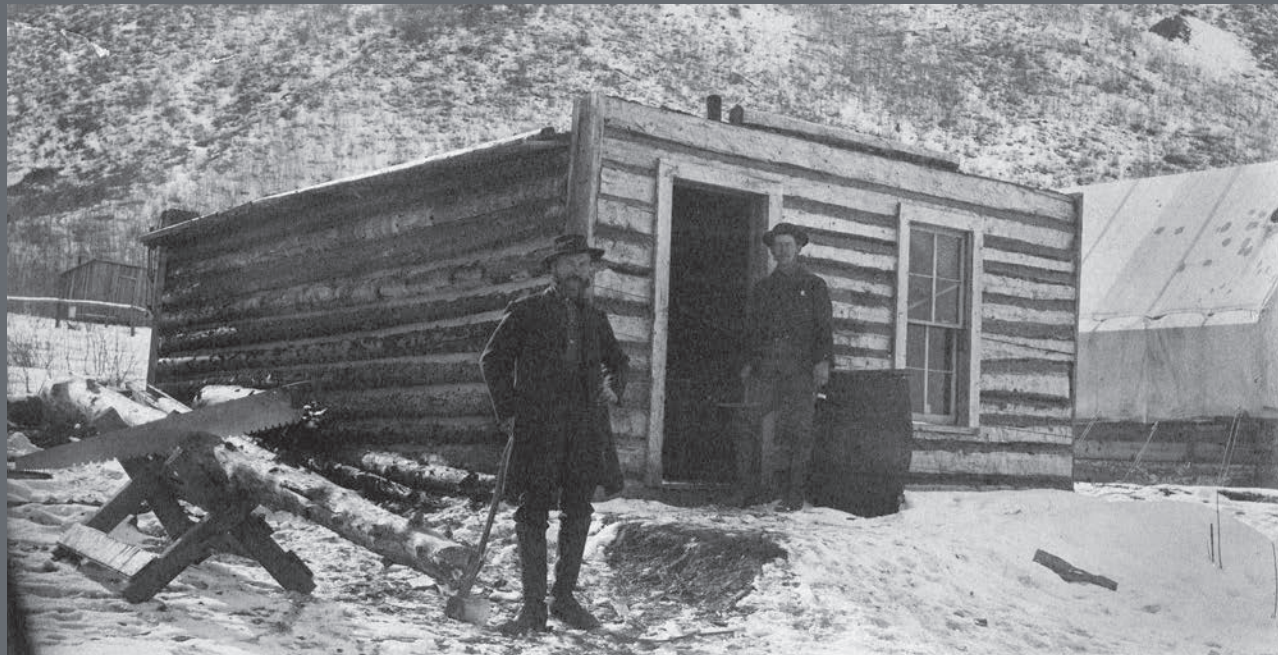
La cabaña que se muestra aquí tiene troncos redondos en los lados y troncos labrados a mano en el frente. Los constructores están utilizando sierras para cortar los troncos y hachas para hacer una superficie plana.
